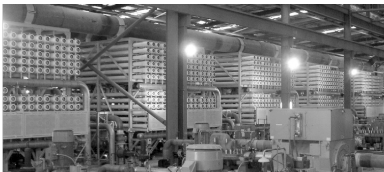
Figure 1-12. Installation de dessalement de l'eau de mer par osmose inverse à Perth, Australie (membranes conventionnelles). Capacité de 143 000 m 3 par jour, l'énergie nécessaire est produite par un champ d'éoliennes.
